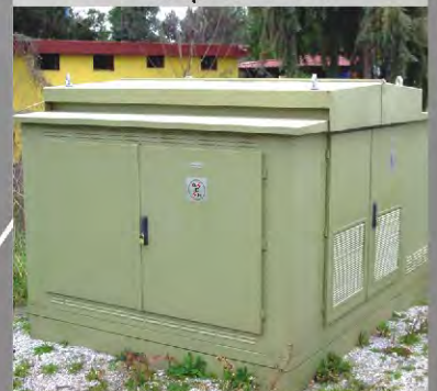
υπαίθριος υποσταθμός διανομής ΔΕΗ
